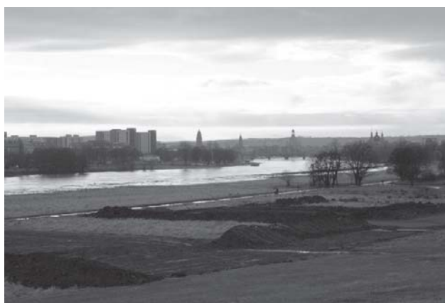
Die Planierarbeiten waren bereits da. Baubeginn der Waldschlösschenbrücke, die den Welterbestatus der sächsischen Hauptstadt Dresdens aufs Spiel setzt. Die Auseinandersetzungen um den Brückenbau gehen weiter, Prozesse sind noch anhängig, evtl. muss gar wieder abgerissen werden. (Infos über die weitere Entwicklung sind zu finden unter: www.waldschloesschenbruecke.de ) Foto: Wilhelm Gröning
